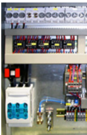
▲ Trasformatore amperometrico nell'armadio elettrico
