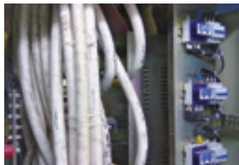
▲ Contatori di energia in ambiente industriale gravoso
