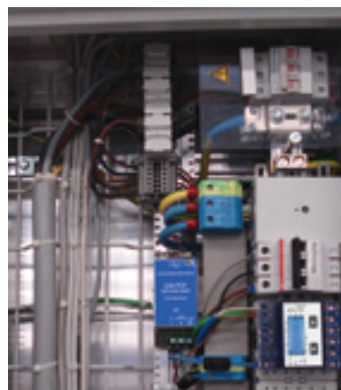
▲ Trasformatori amperometrici installati direttamente nella canaletta dei cavi
