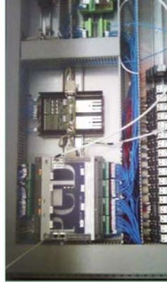
控制柜内部：Saia®PCD2.M5540连接ProfiBus
